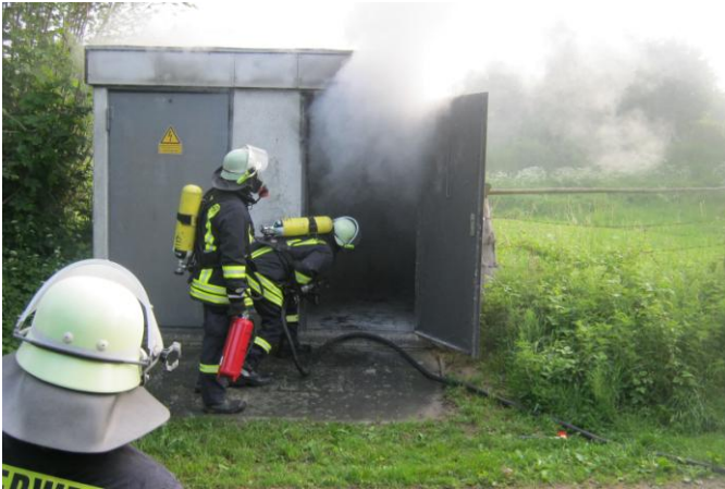
Feuer in einem Trafobaus in Rstorfer Passau am 31.05.2011
